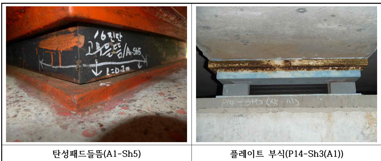
【사진 3.13】 교량받침 손상현황
