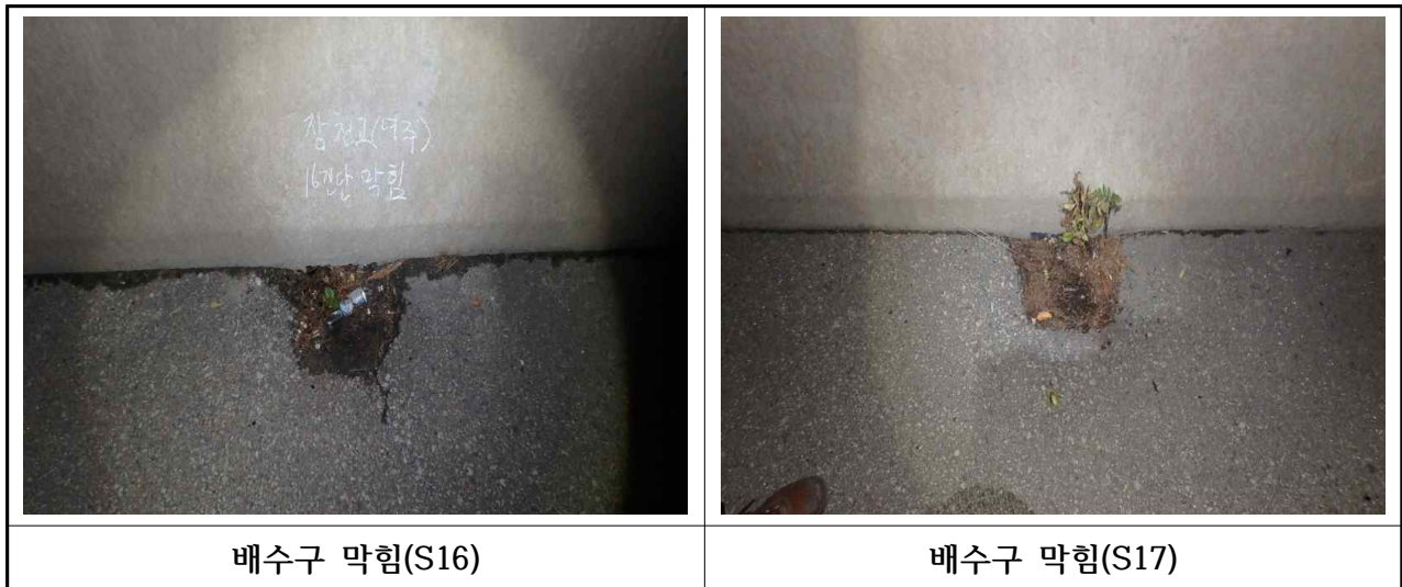
【사진 3.20】 배수시설 손상현황
