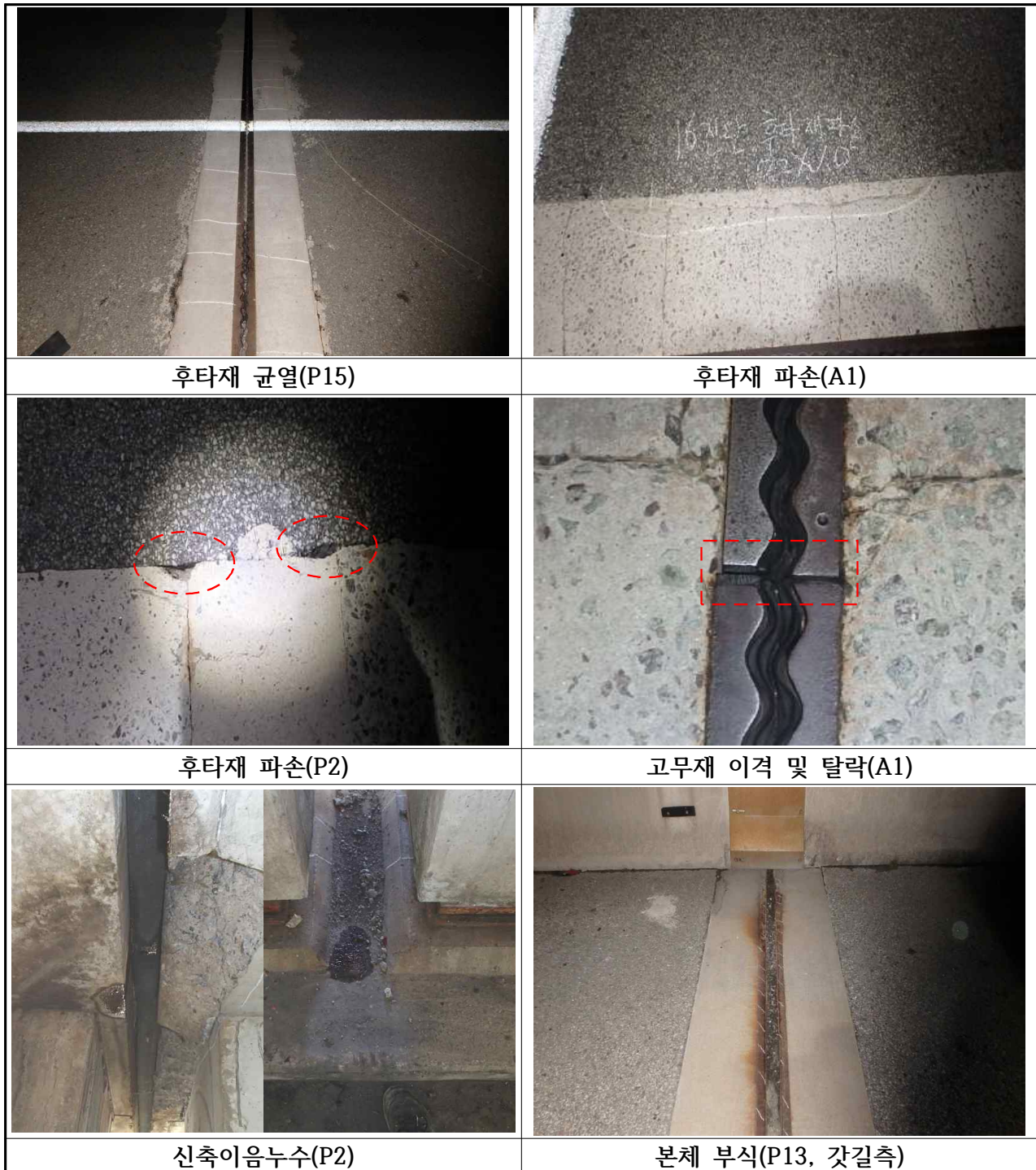
【사진 3.15】 신축이음장치 손상현황
