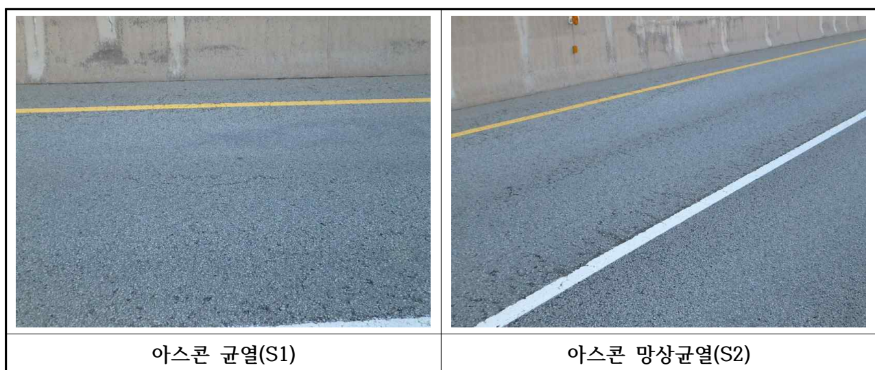
【사진 3.18】 교면포장 손상현황
